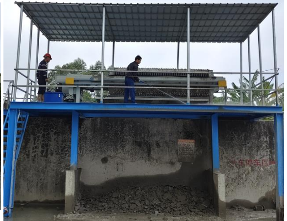
板框压滤机及污泥暂存间
